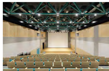
学校の多目的ホールに設置した音響設備
