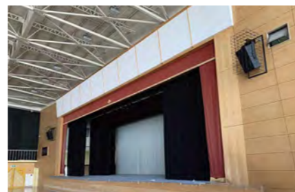
体育館に設置した音響設備
